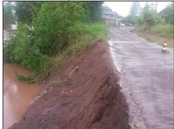
Figura 11-26. Desbarrancamento junto à margem do rio Caí.
