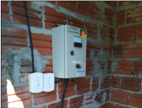
Figura 9-54. Pannel da bomba SAC Arroio 1.
