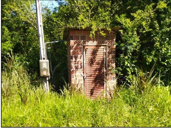
Figura 9-52. Casa de bomba SAC Vigia.
