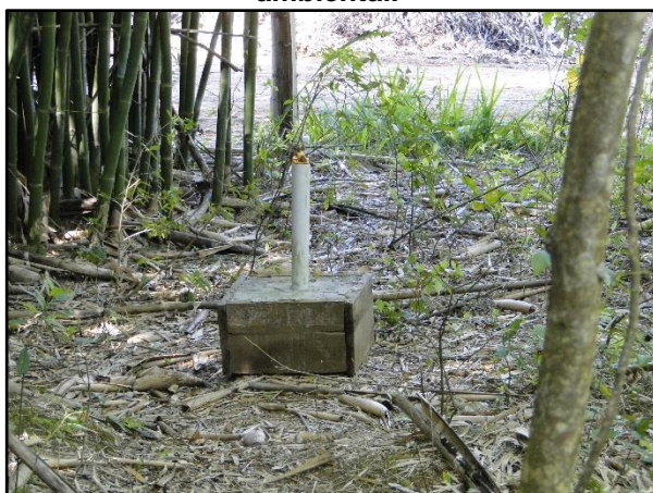
Figura 12-27. Piezômetro para monitoramento ambiental.
