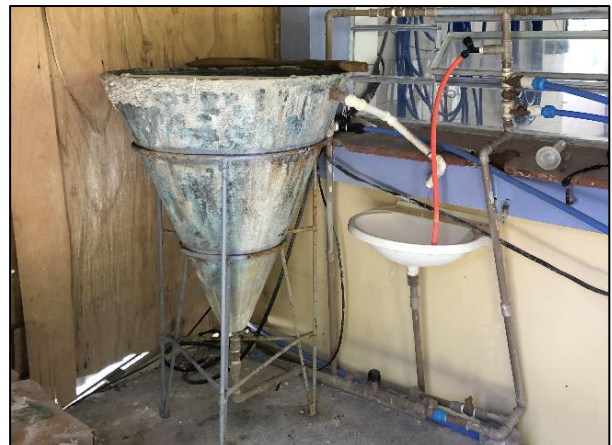
Figura 9-32. Equipamento de dosagem de flúor.
