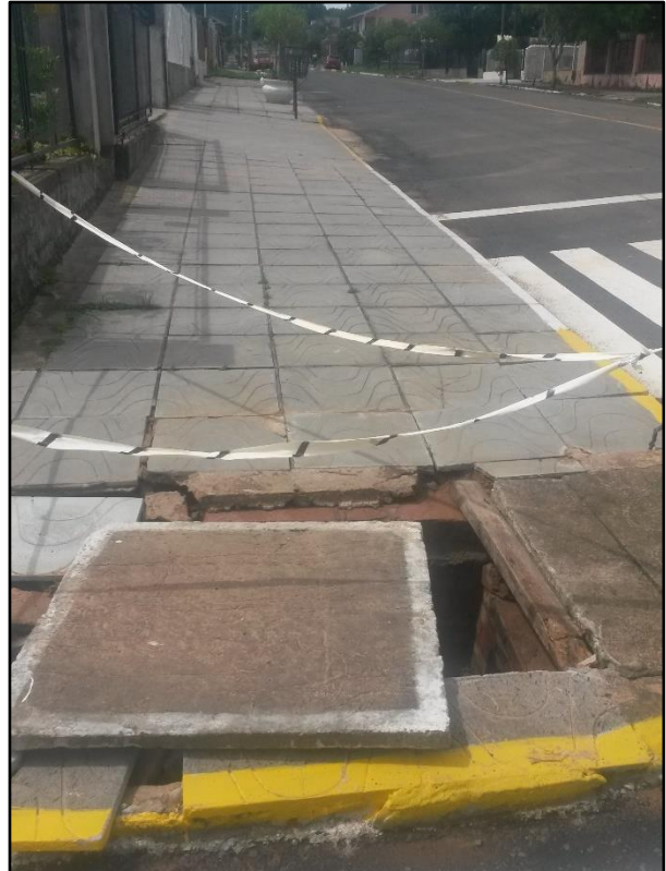
Figura 11-42. Danos ao sistema de drenagem urbano após a enchente de outubro de 2015.
