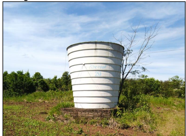
Figura 9-57. Reservatório SAC Arroio 2.
