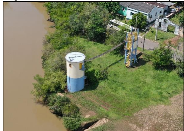
Figura 9-18. Vista aérea do ponto de captação
