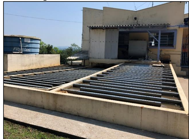
Figura 9-24. Vista do floculador
