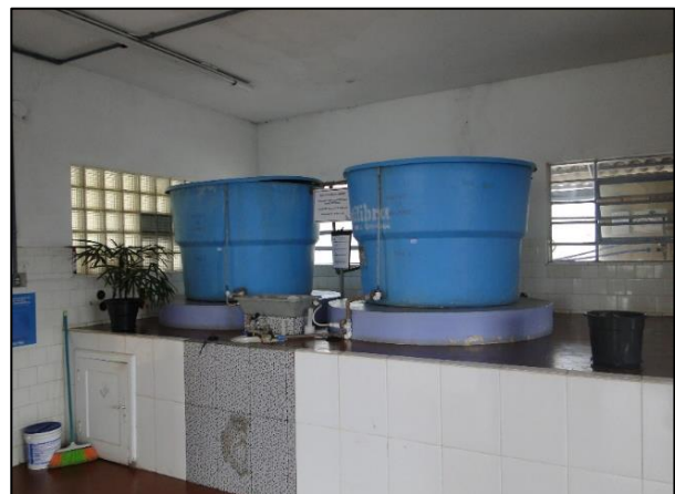
Figura 9-20. Tanques de armazenamento do sulfato de alumínio
