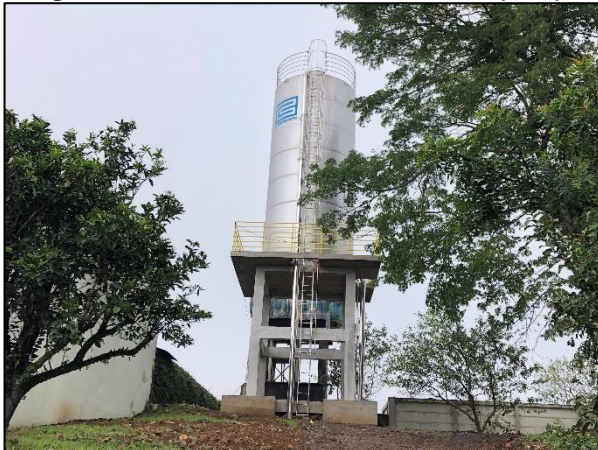
Figura 9-38. Reservatório São Rafael (R05).
