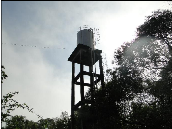
Figura 9-48. Reservatório Reserva Natural (R11).
