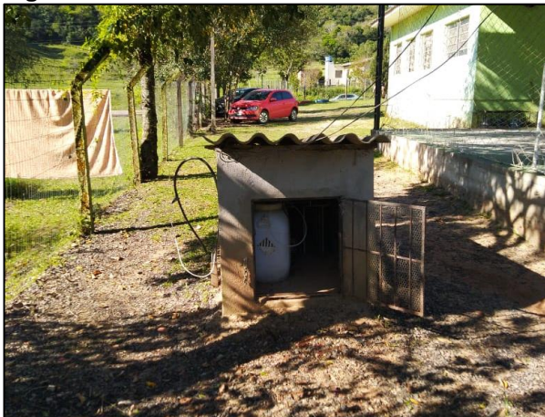
Figura 9-66. Casa de bomba SAC Santo Inácio.
