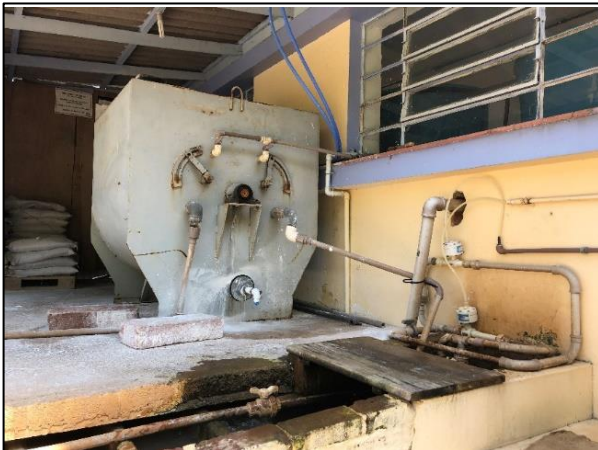
Figura 9-21. Equipamento de armazenamento de sulfato de alumínio
