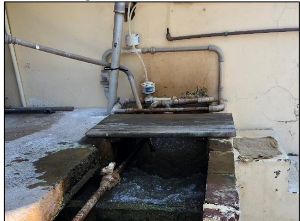
Figura 9-22. Ponto de turbilhonamento na dosagem do sulfato de alumínio
