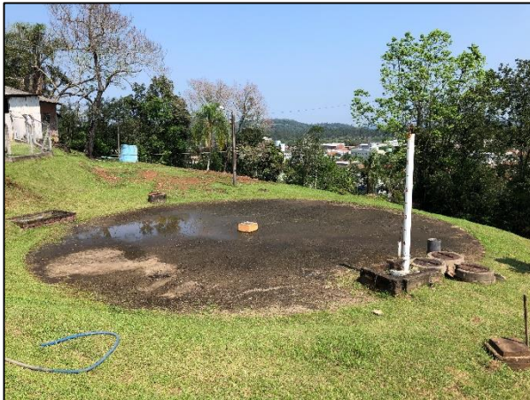
Figura 9-36. Reservatório ETA-R1 (R0).
