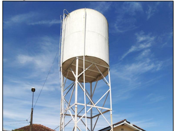
Figura 9-55. Reservatório SAC Arroio 1.
