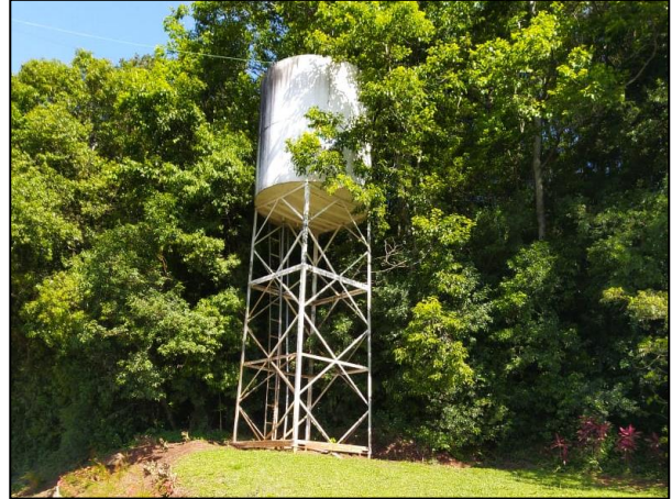
Figura 9-53. Reservatório SAC Vigia.
