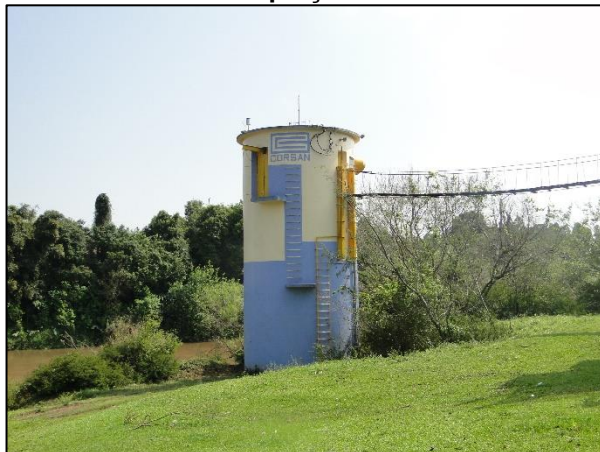
Figura 9-9. Casa de bombas no ponto de captação.
