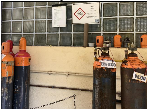
Figura 9-31. Armazenamento dos cilindros de gás cloro.
