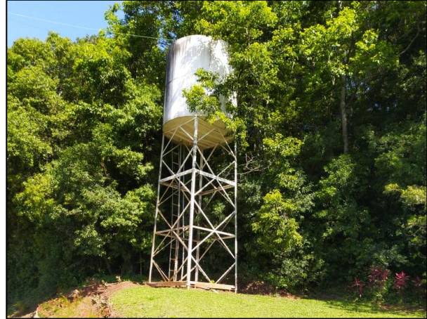
Figura 9-53. Reservatório SAC Vigia.
