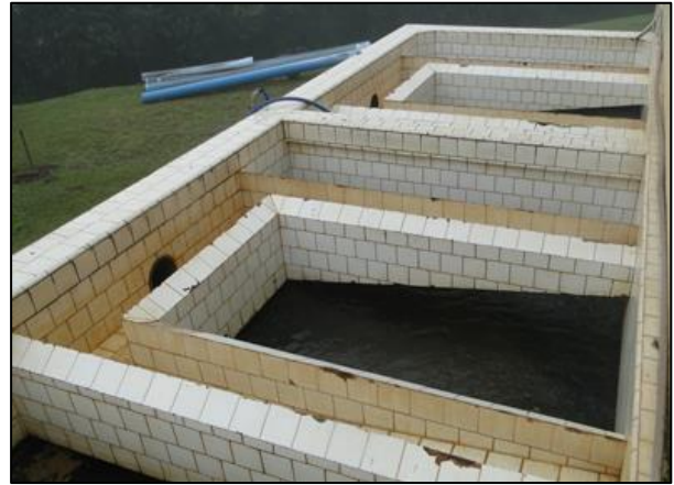
Figura 9-28. Vista dos filtros rápidos
