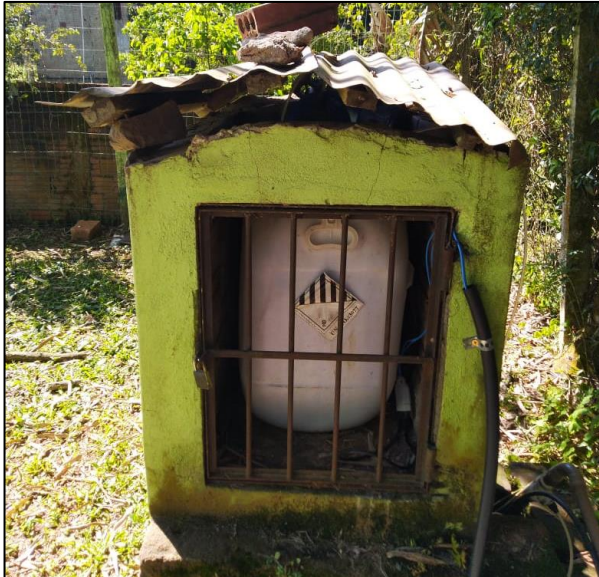
Figura 9-60. Casa de bomba SAC Centro Integrado Campestre.
