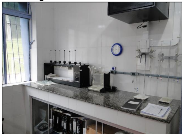
Figura 9-33. Laboratório da ETA
