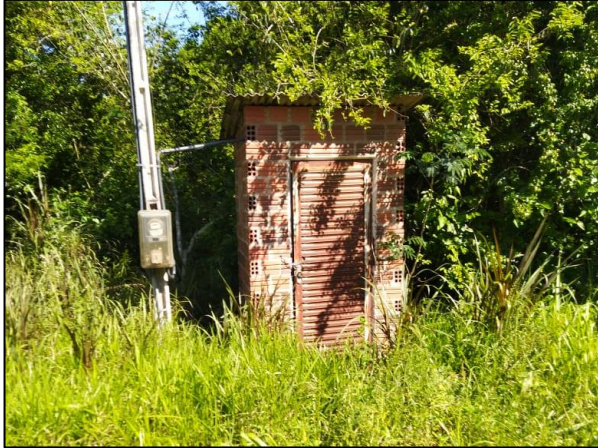
Figura 9-52. Casa de bomba SAC Vigia.
