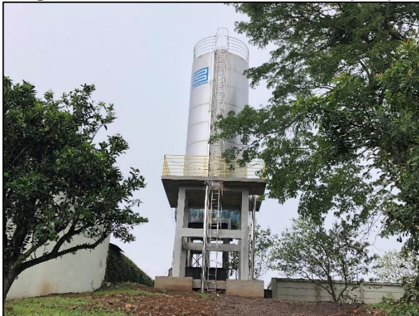
Figura 9-38. Reservatório São Rafael (R05).
