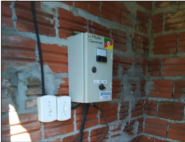
Figura 9-54. Painel da bomba SAC Arroio 1.
