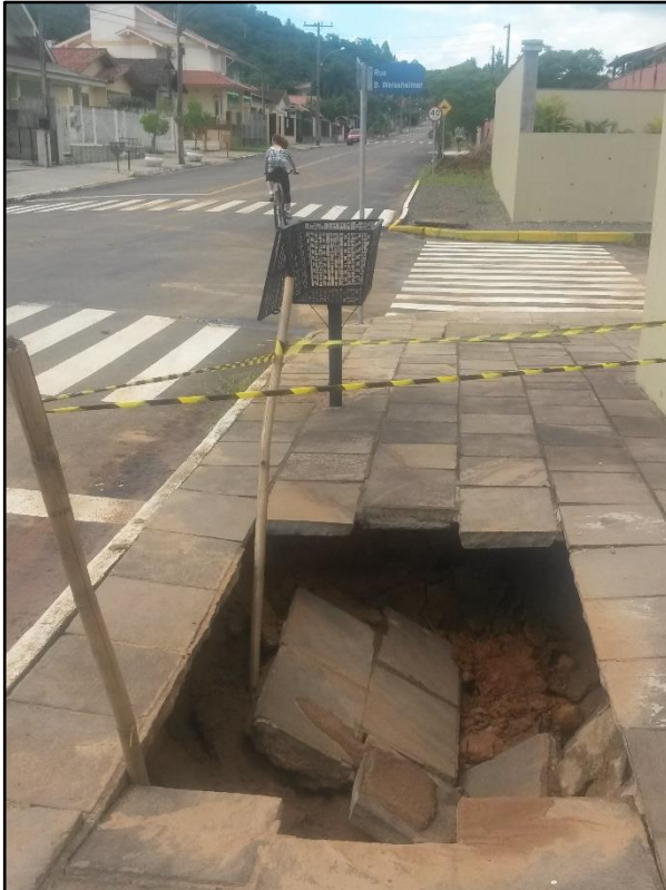
Figura 11-41. Danos ao passeio público após a enchente de outubro de 2015.
