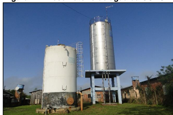
Figura 7-4. Reservatório de água da CORSAN.
