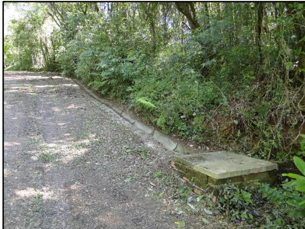
Figura 12-29. Sistema de coleta de lixiviado na área.
