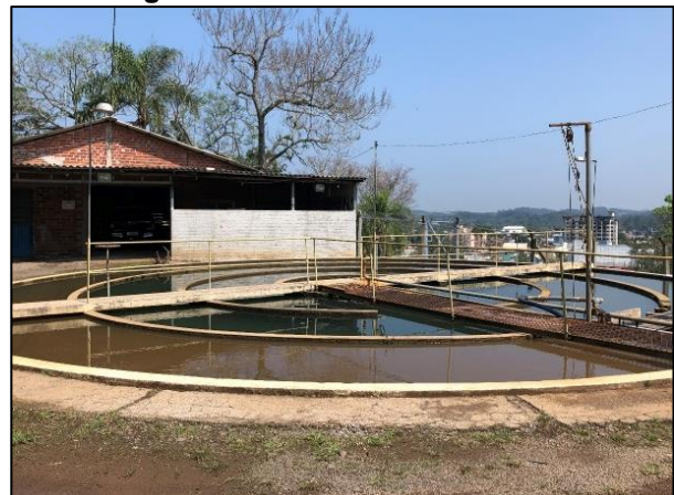
Figura 9-26. Vista do decantador
