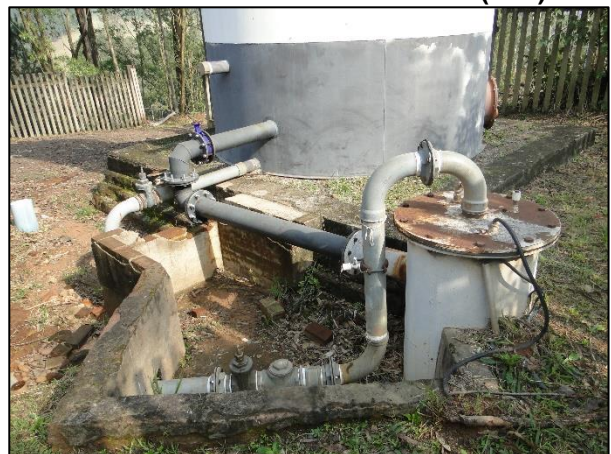
Figura 9-47. Detalhe do recalque no reservatório Nelson Hoof nº 2500 (R02).
