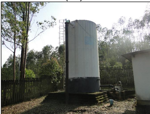
Figura 9-46. Reservatório Nelson Hoof nº 2500 (R02).
