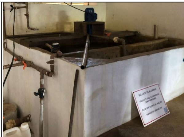
Figura 9-19. Tanque de dissolução do sulfato de alumínio
