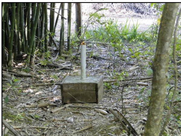
Figura 12-27. Piezômetro para monitoramento ambiental.
