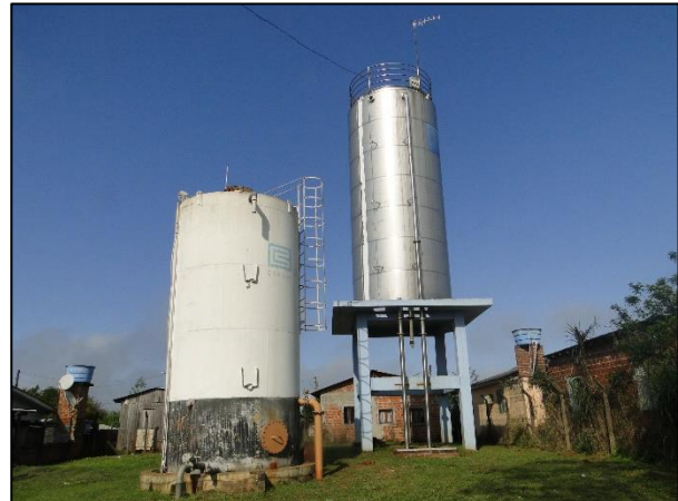
Figura 9-49. Reservatórios São Martin (R03).
