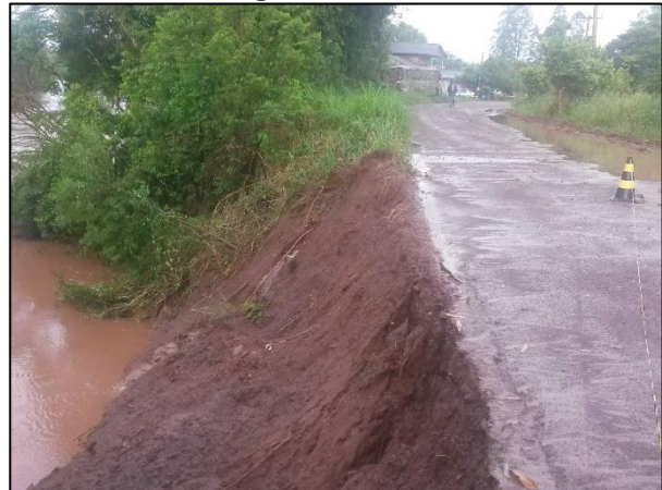
Figura 11-26. Desbarrancamento junto à margem do rio Caí.
