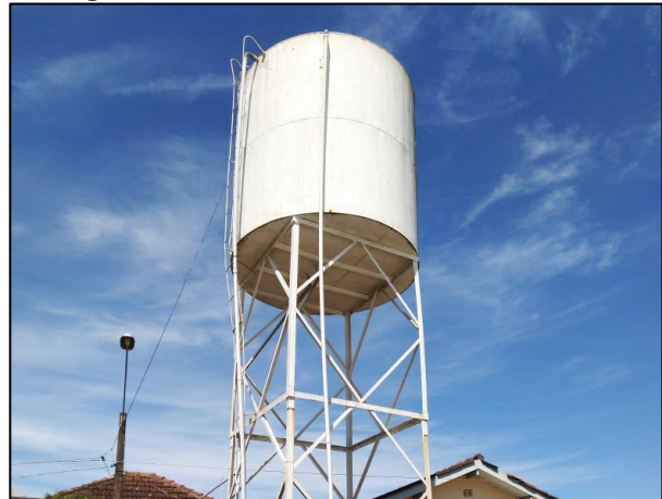
Figura 9-55. Reservatório SAC Arroio 1.
