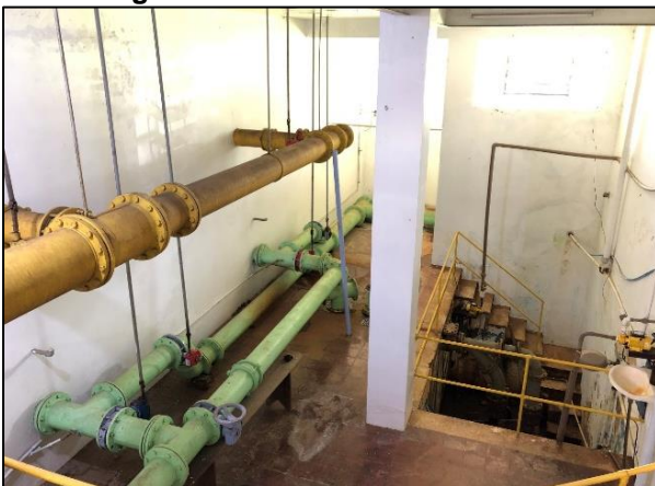
Figura 9-29. Válvulas de controle
