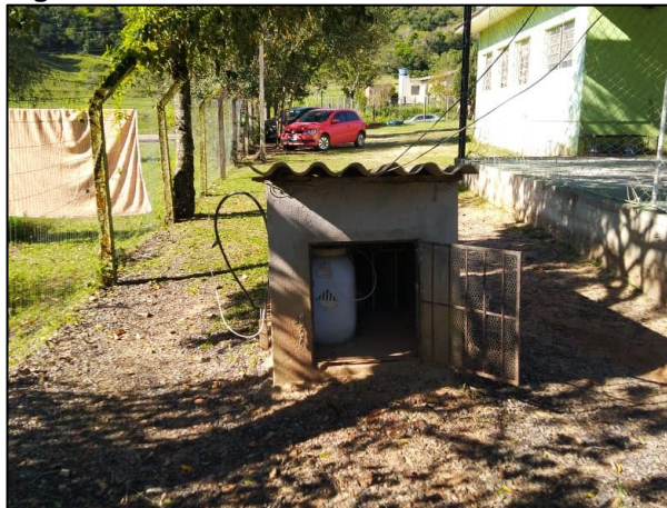
Figura 9-66. Casa de bomba SAC Santo Inácio.
