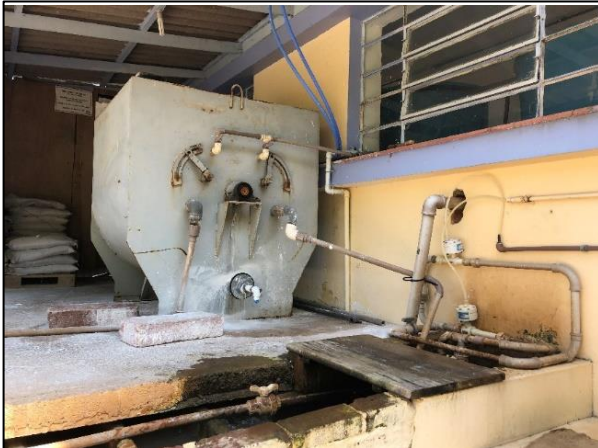
Figura 9-21. Equipamento de armazenamento de sulfato de alumínio
