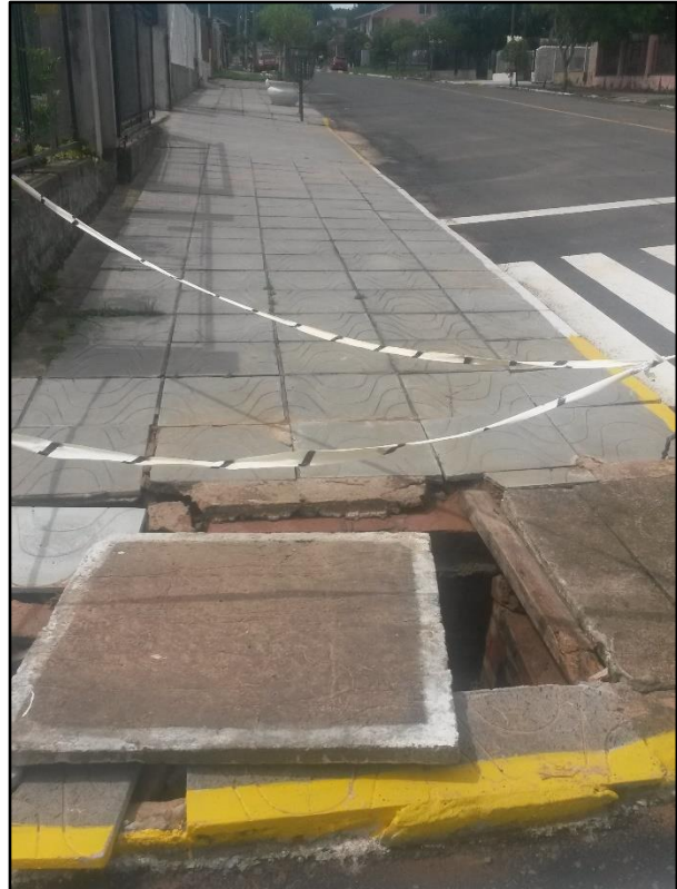
Figura 11-42. Danos ao sistema de drenagem urbano após a enchente de outubro de 2015.
