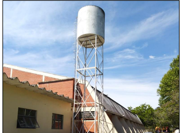
Figura 9-59. Reservatório SAC Parque Centenário.
