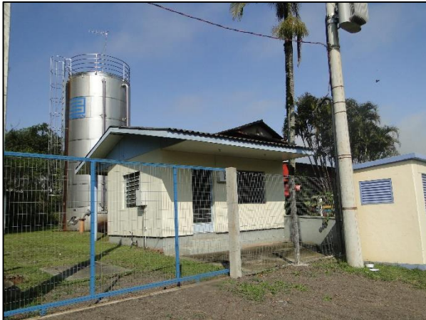
Figura 9-44. Reservatório Nelson Hoof nº 853 (R01).
